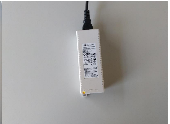
Injecteur PoE (sous tension)
