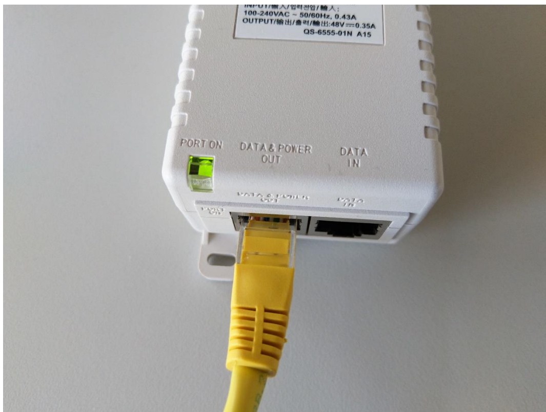
Injecteur PoE branché et fonctionnel
